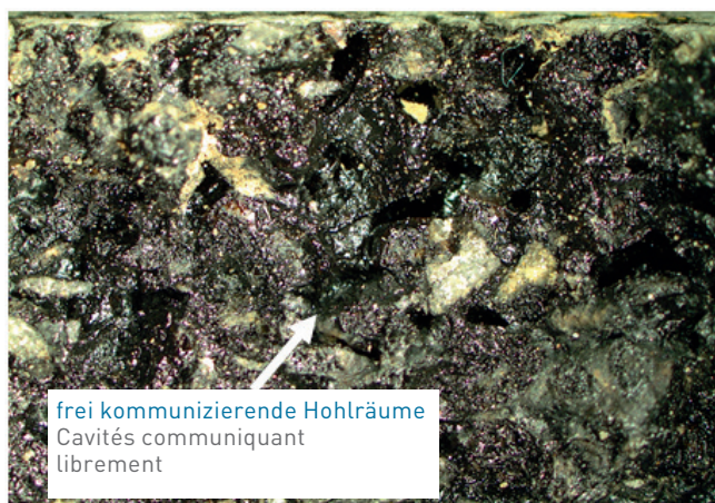
Schichttiefe 20–40 mm: Hohlräume nicht verschmutzt . Profondeur de couche 20–40 mm: cavités non encrassées.
